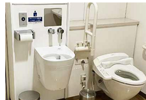
本社ビルに設置したオストメイト対応トイレ
