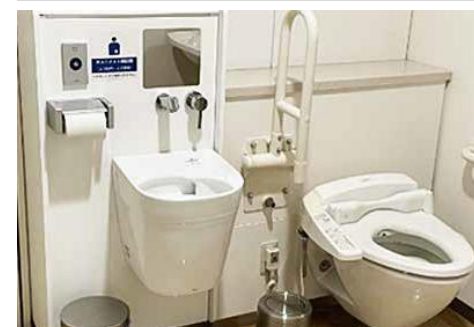
本社ビルに設置したオストメイト対応トイレ
